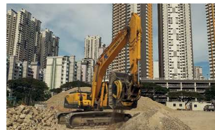
La benne frantoio al lavoro in un cantiere alle porte di Singapore
